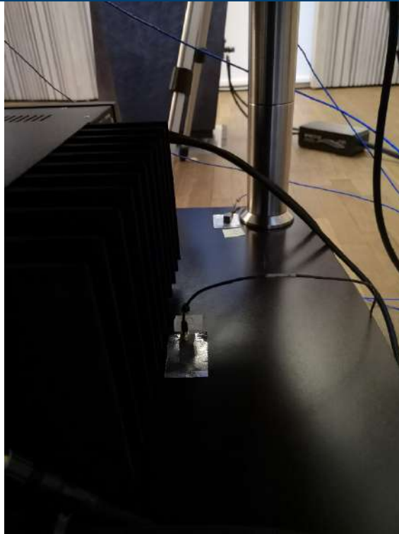
Figura 8. Punto di misura 15.
